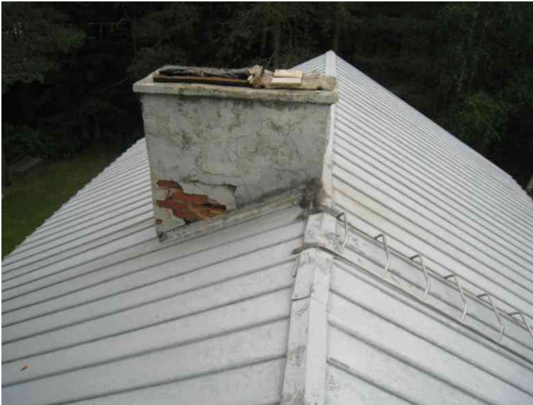
Kuva 4 Vesikate on vanha galvanoitu teräspeltikate. Savupiippu on rapautunut.
