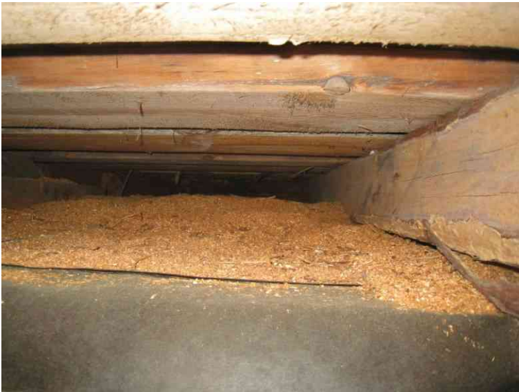
Kuva 8 Vinolla osalla sahanpurun / vesikatteen alustan välissä on tuuletusväli.
