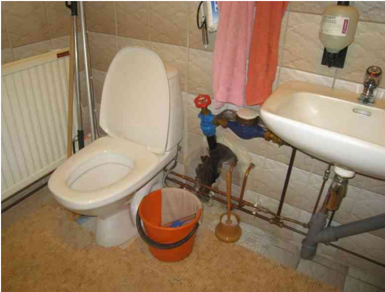
Kuva 16 Seinään tehty reikä on paikkaamatta. On tehty vesijohtojen korjauksen takia.
