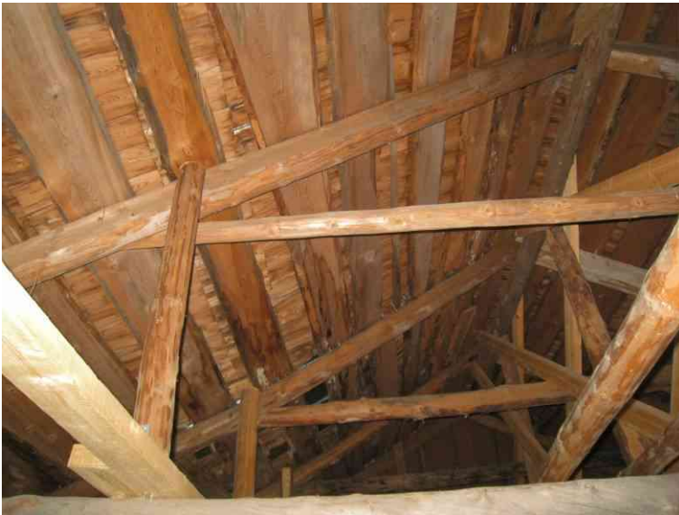
Kuva 26 Rak 3 :n vesikaton rakenteita. Katepellin alla on vanha päre. Kattorakennetta on jäykistetty.
