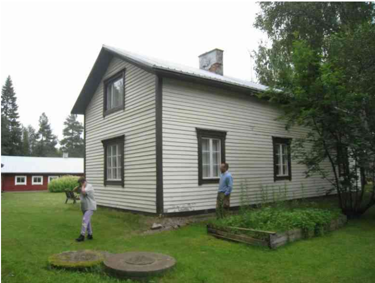
Kuva 2 Perustuksen korkeus on matala. Perustus on levytetty. Alapohjan rossipohja on (lähes) maata vasten.
