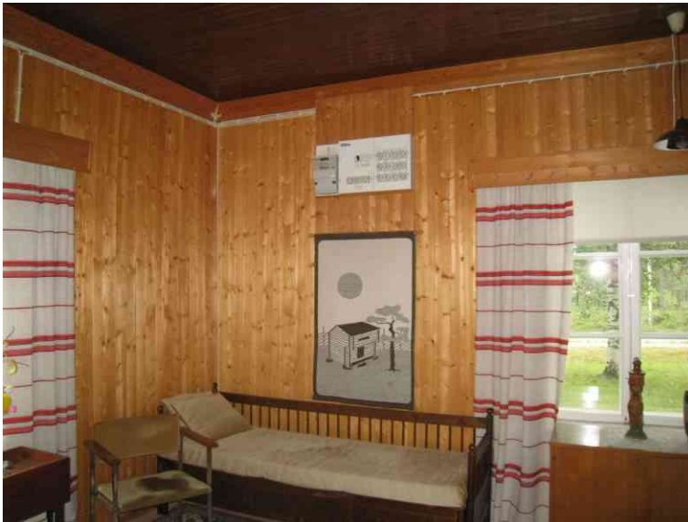
Kuva 14 Pirtissä on sähkökeskus.
