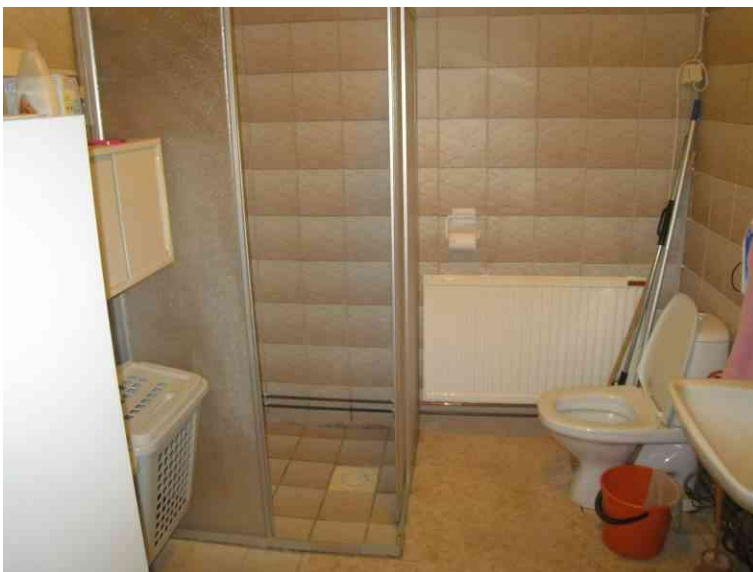
Kuva 15 Suihkutilan lattian kosteus 2,5-3 %/E4; normaali. Muualla < 2 %; kuiva. Seinien kosteus < 2 %/E2; kuiva. Vedeneristeitä ei liene 80 öluvulla käytetty.
